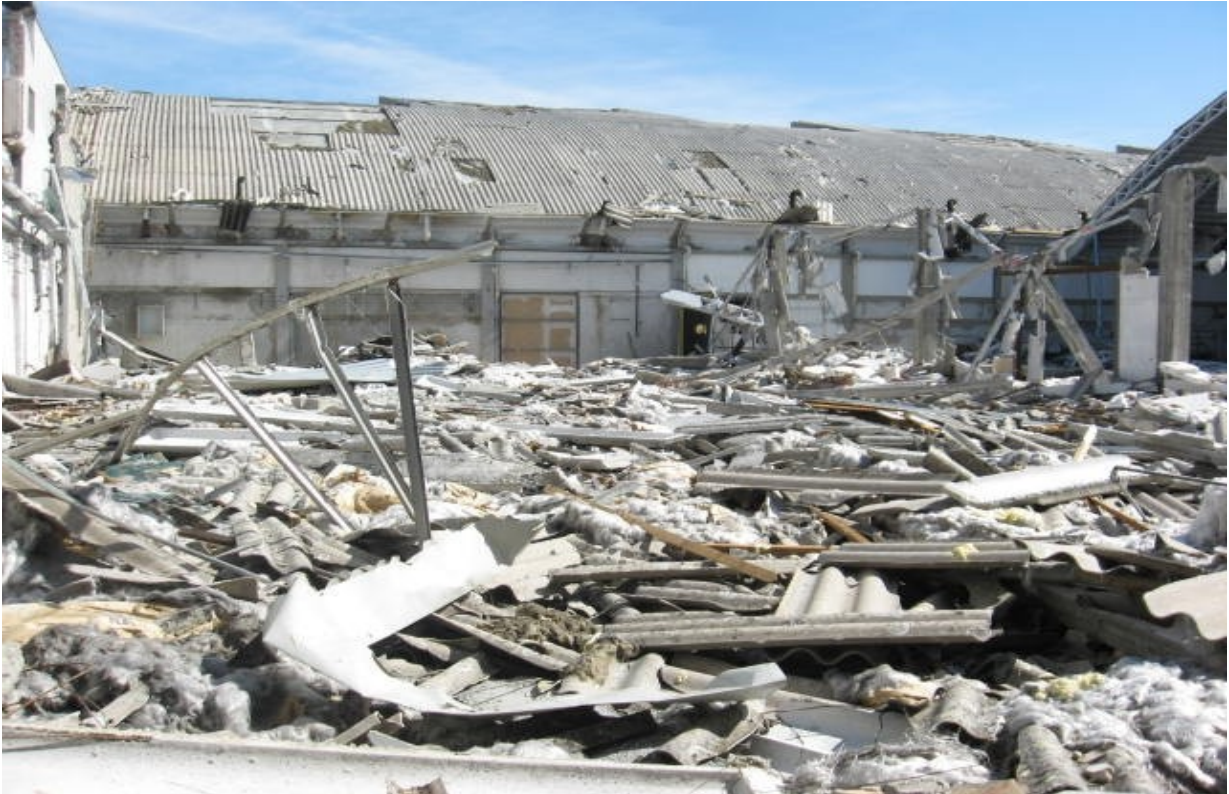
Figura 18 - Crollo e dispersione della copertura in cemento-amianto a Cerreto Guidi – settembre 2014
