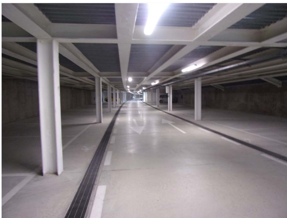
Parcheggio B – posti auto al coperto, ubicati al disotto della passeggiata panoramica nord, e raggiungibili tramite chip di apertura della sbarra.
