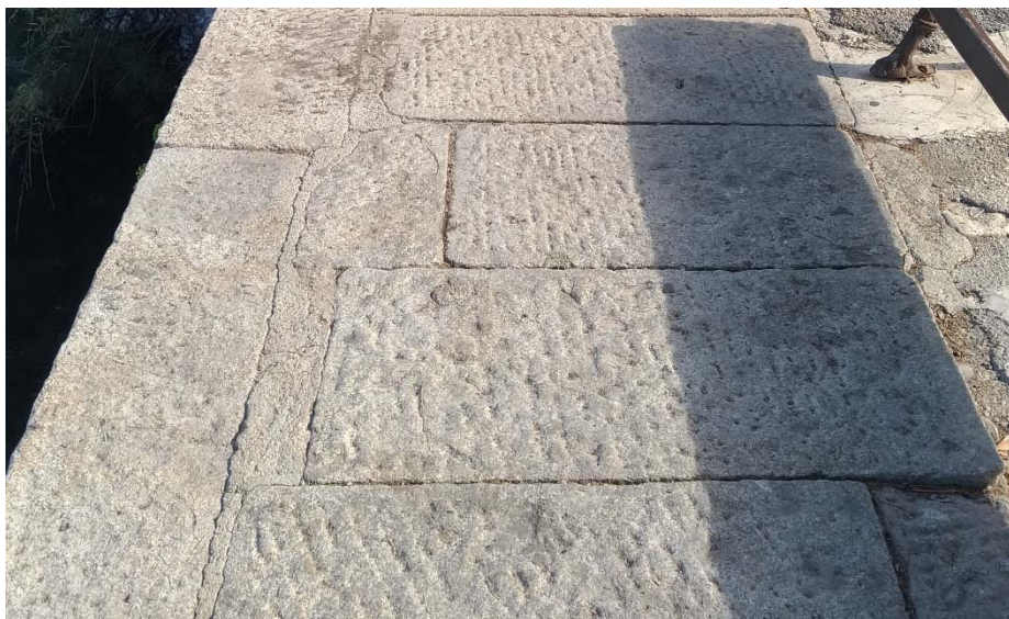
Foto 6.5-6.7 Viale Margherita, tipologie di pavimentazione della banchina. A fianco: pavimentazione dotata di un buon livello di accessibilità; sotto e in fondo alla pagina: pavimentazione impraticabile per persone su sedia a ruote.
