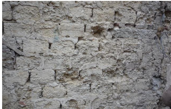
Figura 5: Muratura in masselli (prova 049).
