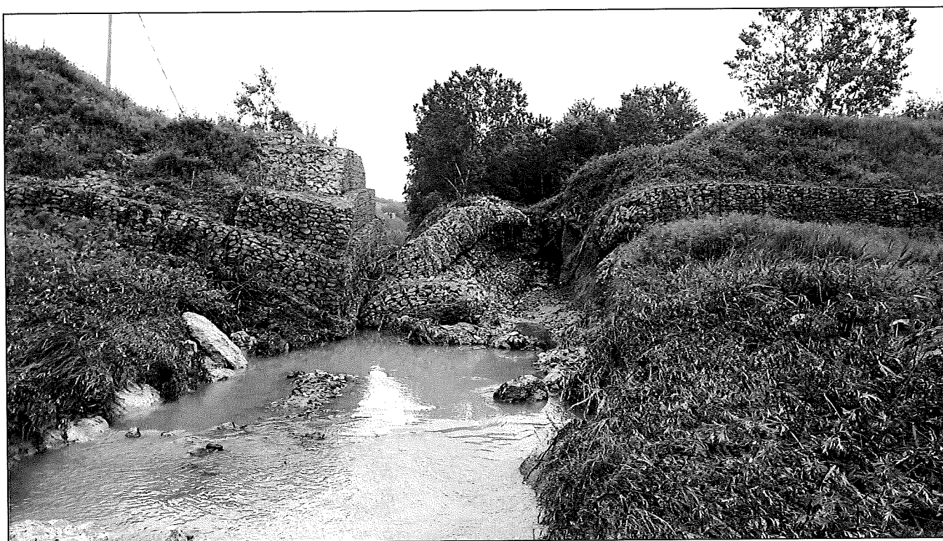
Vista da valle verso monte della bocca tarata in gabbioni danneggiata dall'evento
