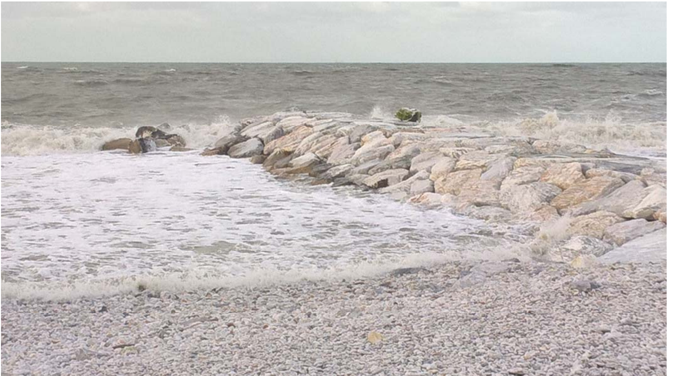
Dissesto del pennello di separazione celle 4 e 5
