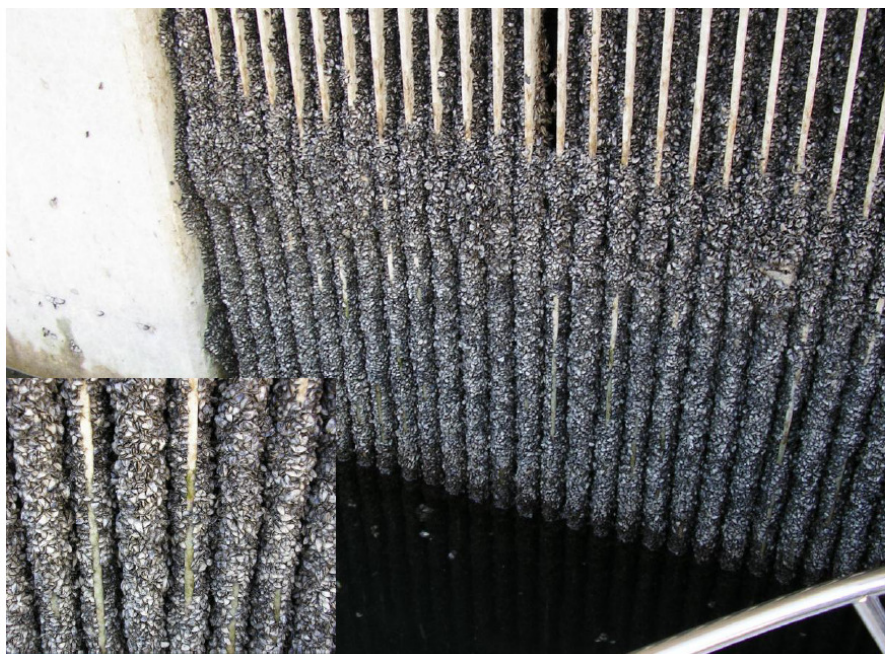
Figura 30. Griglie di presa dell'acqua alla diga di Bilancino (Firenze) incrostate da Dreissena polymorpha (foto di P. Grossi).
