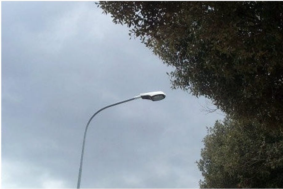
Figura 26 - Lampione stradale originariamente con coppa sporgente prismata sostituita con chiusura in vetro piano temperato.
