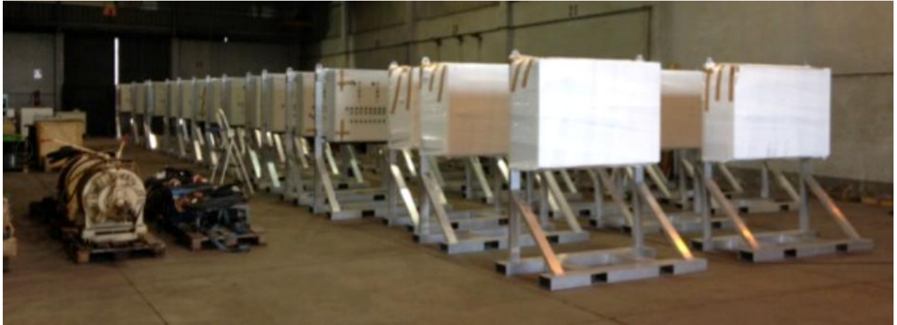
Sopra: quadri del sistema di controllo della zavorra dei cassoni a Piombino
