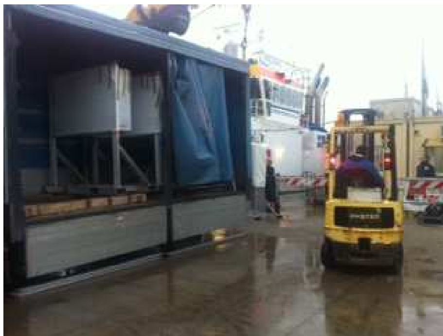
Sotto: Primi pannelli del Sistema di Controllo di Zavorra in area di lavoro
