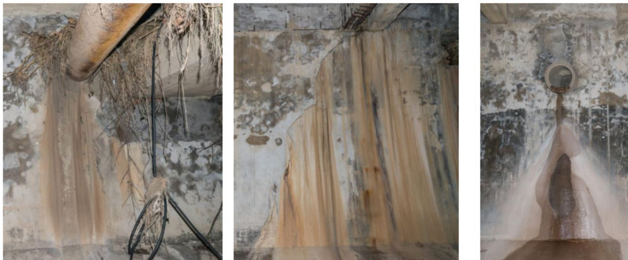
immagini mostranti scarichi, infiltrazioni e tubazioni passanti (si noti in quella a sinistra l'ingombro dell'attraversamento fognario)
