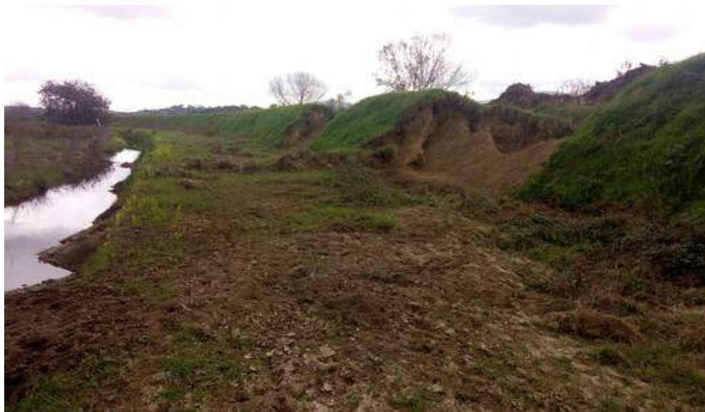
Figura 22: cedimenti dell'argine destro del torrente Ugione in occasione dell'evento del 10 settembre 2017 nel tratto in esame (vista sul lato campagna)
