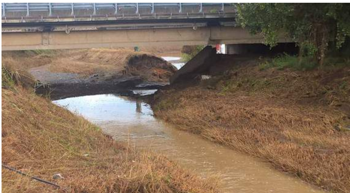
Figura 3: crollo dell'argine destro del T.Ugione presso il ponte della Variante Aurelia in occasione dell'evento del 10 Settembre 2017
