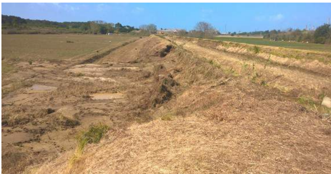
Figura 1: crollo delle arginature del T. Ugione in sinistra idraulica nel tratto compreso tra il ponte di via Aiaccia e il ponte della Variante Aurelia in occasione dell'evento del 10 Settembre 2017
