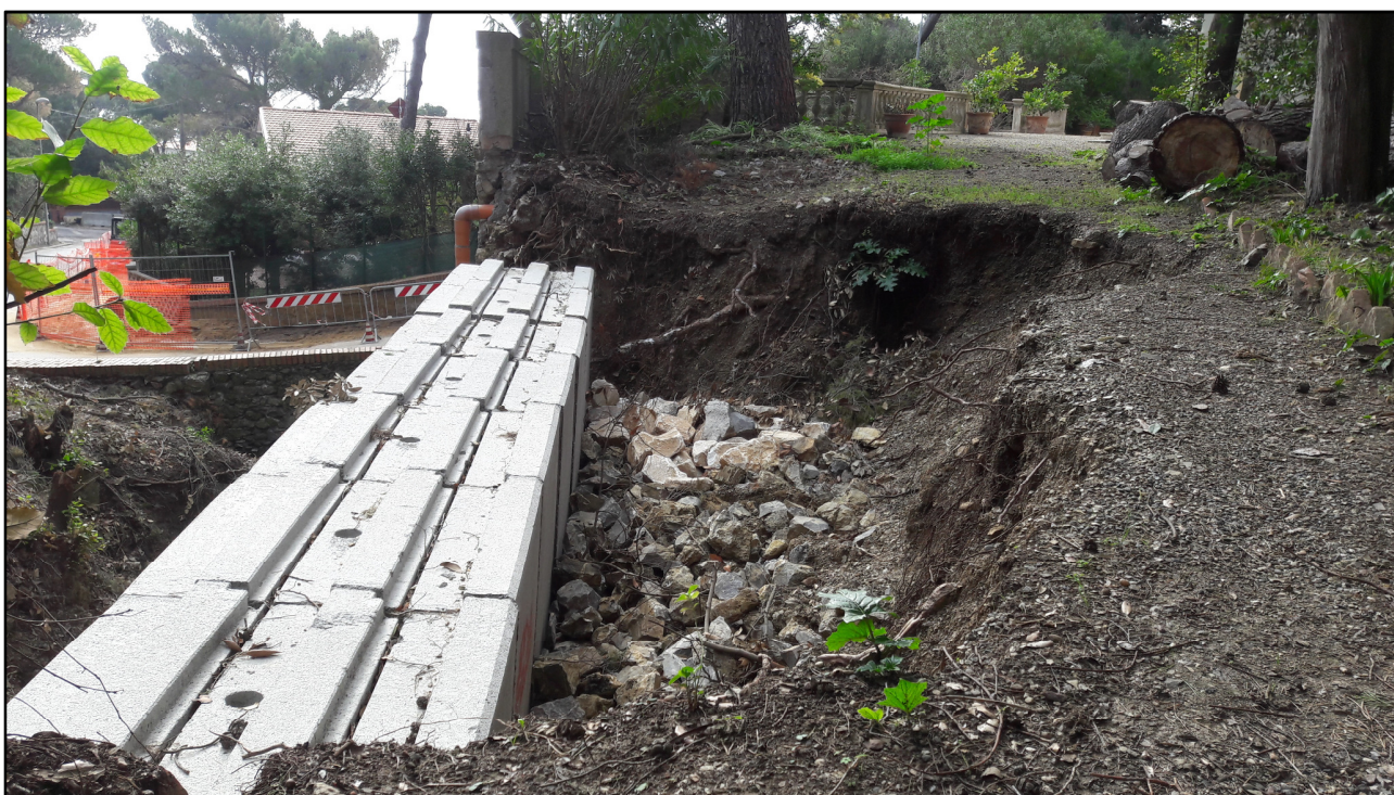
FOTO 6. VISTA DALLA SOMMITÀ SPONDALE DESTRA DEL MURO IN GEBLOCCHI REALIZZATO IN SOMMA URGENZA E DEI CEDIMENTI RETROSTANTI
