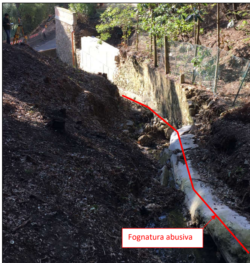
FIGURA 3. FOGNATURA ABUSIVA AL PIEDE DEL MURO IN SPONDA DESTRA
