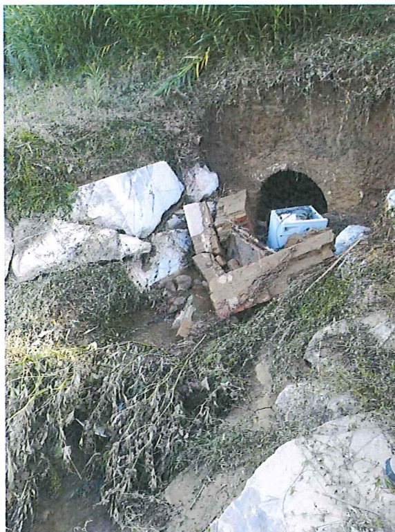
Foto 1 - Collasso dei muri di spalla e del setto frontale del manufatto di immissione del fosso in sinistra idraulica del fiume Tora loc. Le Murelle (Collesalveti).
