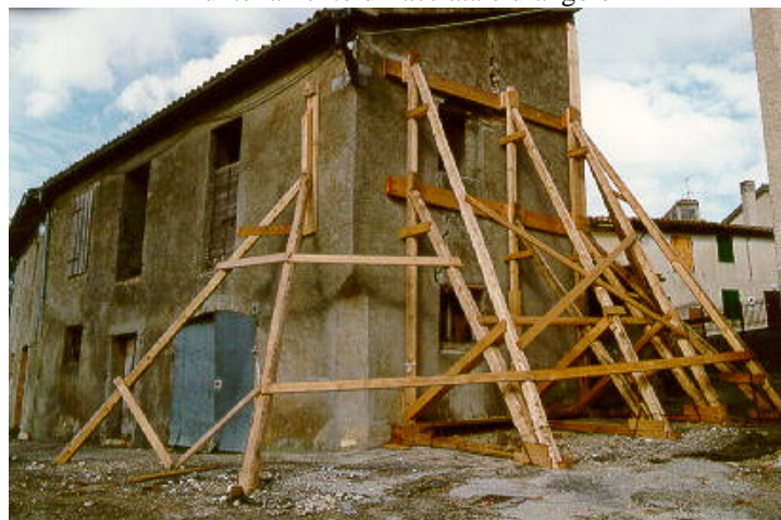
Figura 3. Cesi (Mc) –Terremoto del 26.09.97. Puntellamento di facciata e d'angolo
