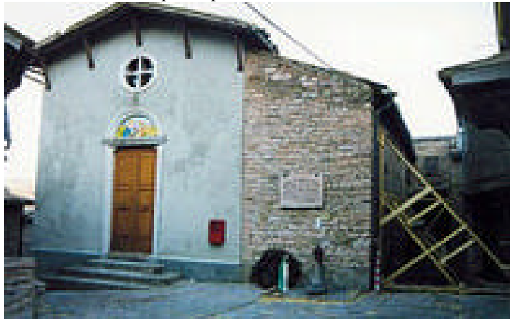
Figura 4. Spello (Pg) – Terremoto del 26.09.97. Puntellamento della parete perimetrale della Chiesa di S. Giovanni .
