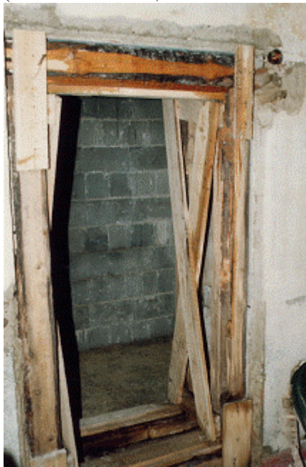
Foto 5.1. Sbadacchiatura di vano porta (Muro Lucano – PZ, 1997 Convento dei Cappuccin)
